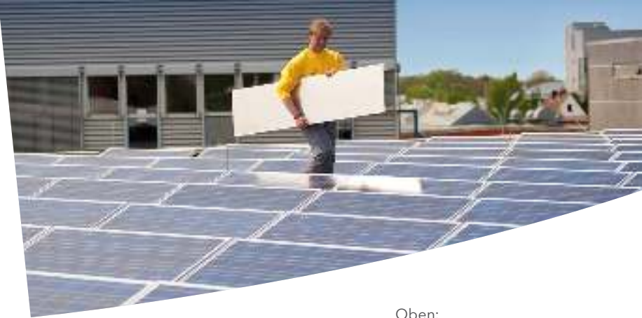
Oben: Industriedach Steinfurt, Solarstrom-Großanlage
